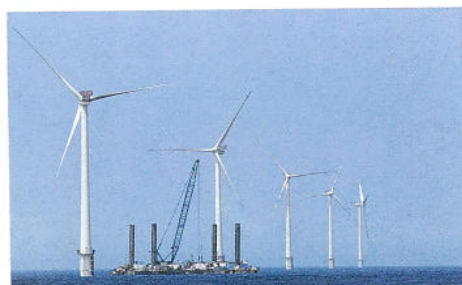
Fra havvindmølleprojektet på Horns Rev ud for Esbjerg.
